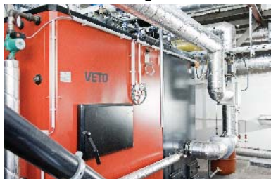
Die Biomasse-Feuerung erzeugt Wärme aus unbelasteten Holzabfällen Bild: enercity Contracting
